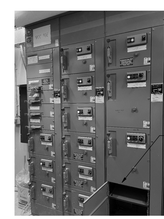
3 EXISTING SWITCHGEAR MCC-10E E010 N.T.S
