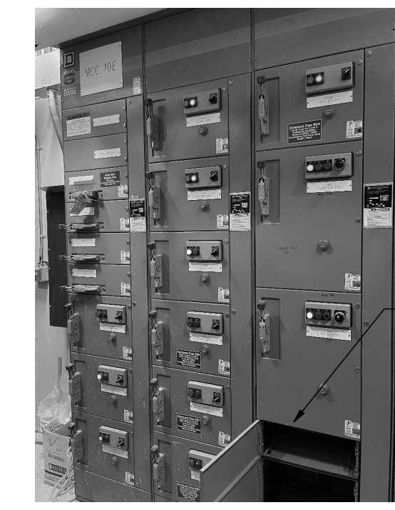
3 EXISTING SWITCHGEAR MCC-10E E010 N.T.S
